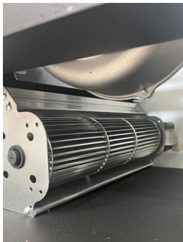
Abbildung 31 - Reinigen des Raumventilators
